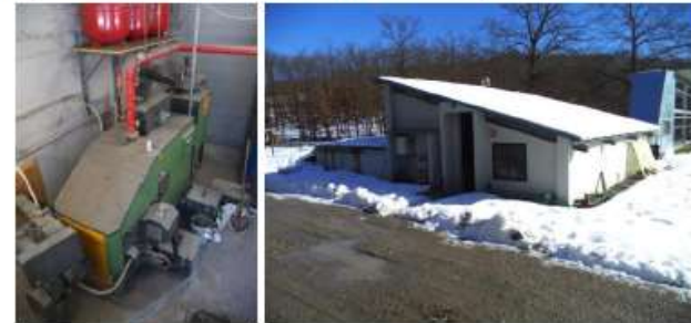
Figura 24: Caldaia a cippato HDG Compact 150 nel locale tecnico seminterrato
