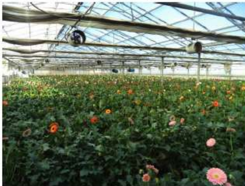
Figura 21: Interno della serra con dettaglio delle condotte per il riscaldamento e la deumidificazione
